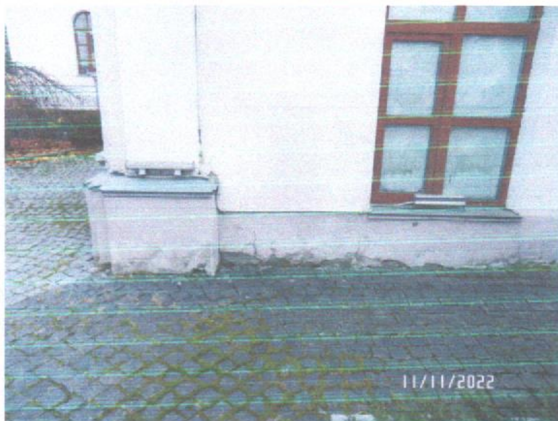
Фото 4. Замокання та руйнування опорядження цоколя західного фасаду колегіуму.
